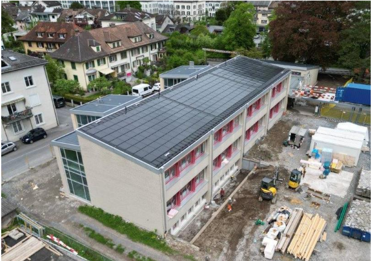
PV-Anlage Glärnischstrasse 1 a (Trakt Nord von Waisenhausstrasse 12)
